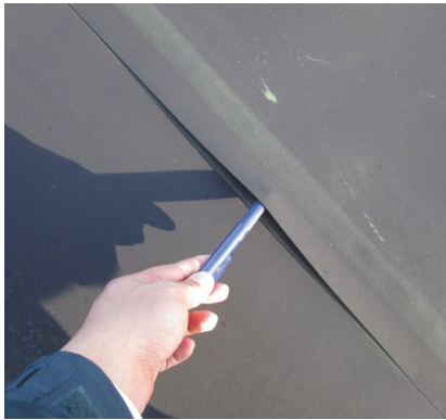
アスファルト防水の膨れ（上）とシート系防水の継ぎ目の剥がれ（写真提供／日本防水協会）
